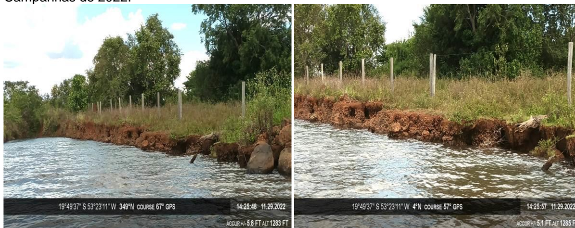
Figura 15 – Ponto 13: Erosão em ravinas, área 1 da PCH Verde 4A, no município de Água Clara/MS. Campanhas de 2022.
