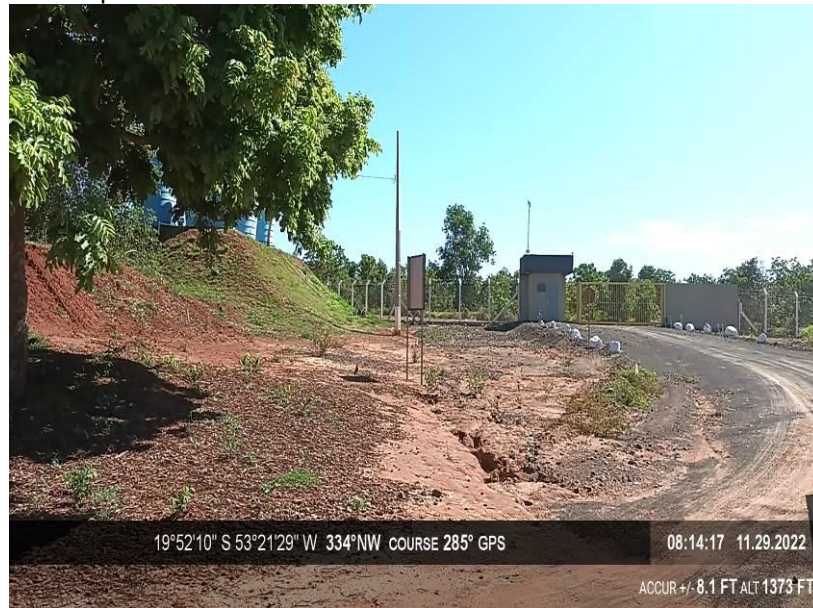
Figura 4 – Ponto 2: Erosão em sulco próximo a guarita da usina, área 1 da PCH Verde 4ª no município de Água Clara/MS. Campanhas de 2022.
