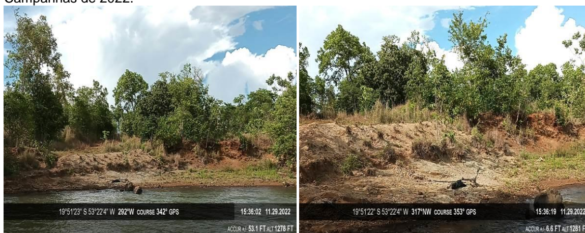
Figura 11 – Ponto 9: Erosão laminar, área 1 da PCH Verde 4A, no município de Água Clara/MS. Campanhas de 2022.
