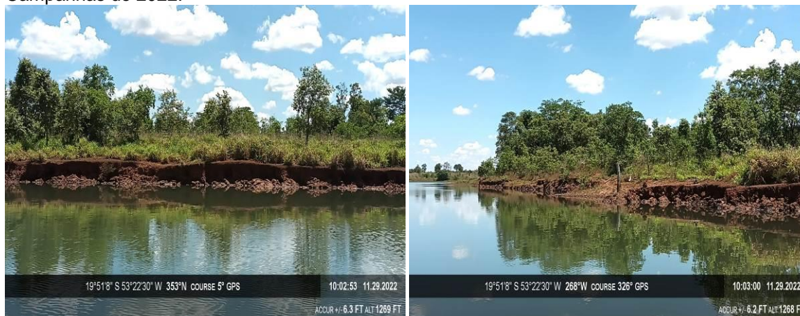
Figura 12 – Ponto 10: Erosão em ravinas, área 1 da PCH Verde 4A, no município de Água Clara/MS. Campanhas de 2022.
