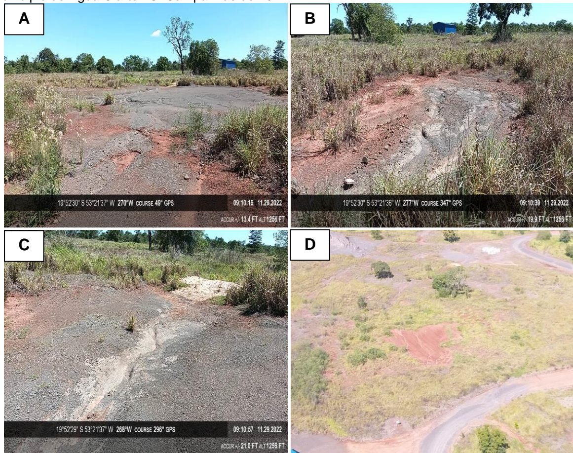
Figura 3 – Ponto 1: Erosão em sulcos, vista terrestre (A - C) e aérea (D) área 1 da PCH Verde 4A no município de Água Clara/MS. Campanhas de 2022.
