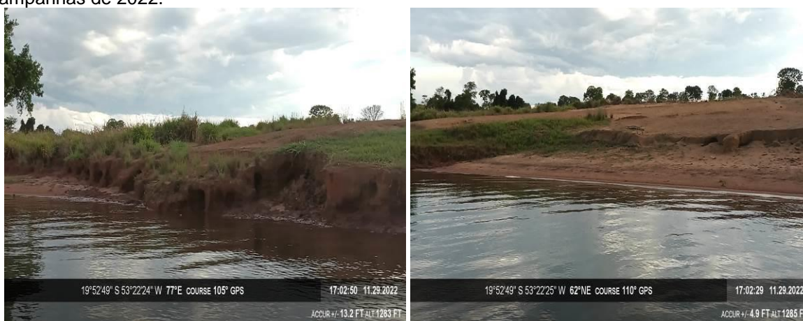
Figura 7 – Ponto 5: Erosão em ravinas, área 1 da PCH Verde 4A, no município de Água Clara/MS. Campanhas de 2022.
